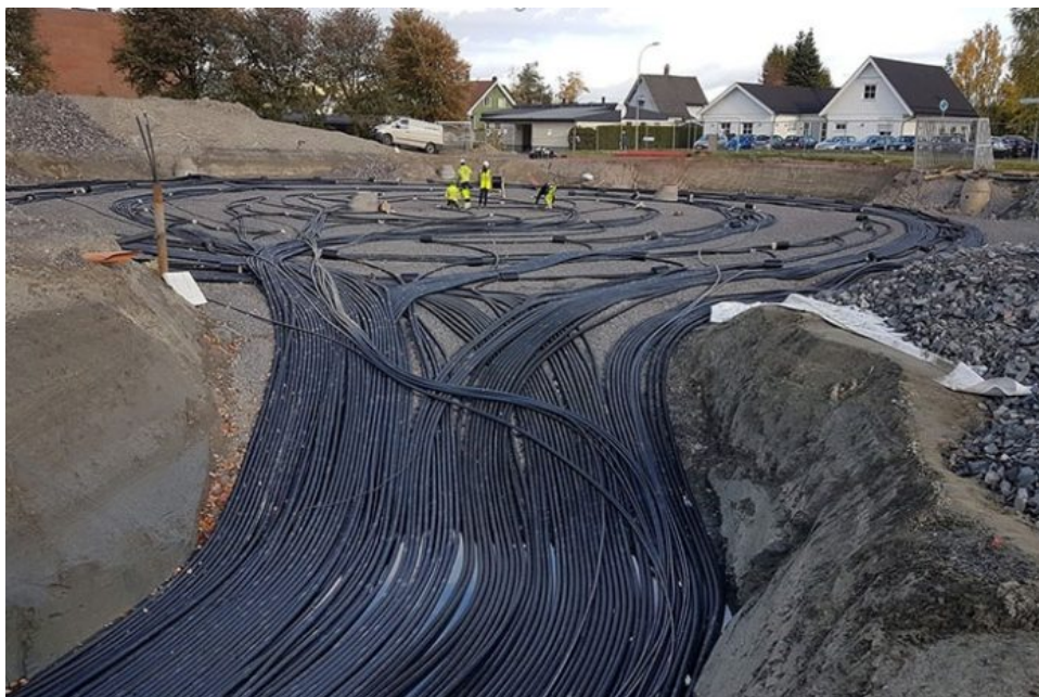
Figur 7 GeoTermos ved Fjell skole i Drammen består av 100 seriekoblede brønner.
