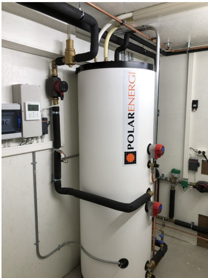
Figur 12 En luft/vann varmepumpeanlegg på 8,1 kW med akkumulatortank.
