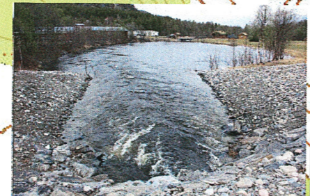
Utløp halvkulvert Flom i Reisaelva
